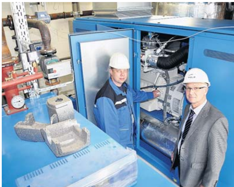
Detlef Pohl (links), Meister der Netztechnik-Wärme, und Michael Bijok, bei der EWE Netz GmbH zuständig für Netzvertrieb und -technik, vor dem Herzstück des Blockheizkraftwerks am TZN: ein auf Gasbetrieb umgerüsteter Sechs-Zylinder-Dieselmotor.
